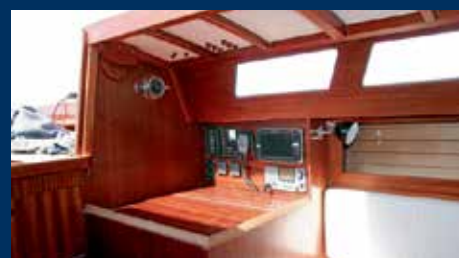
An Steuerbord sind Funk, Kartenplotter und Bordstromverteiler eingebaut.
