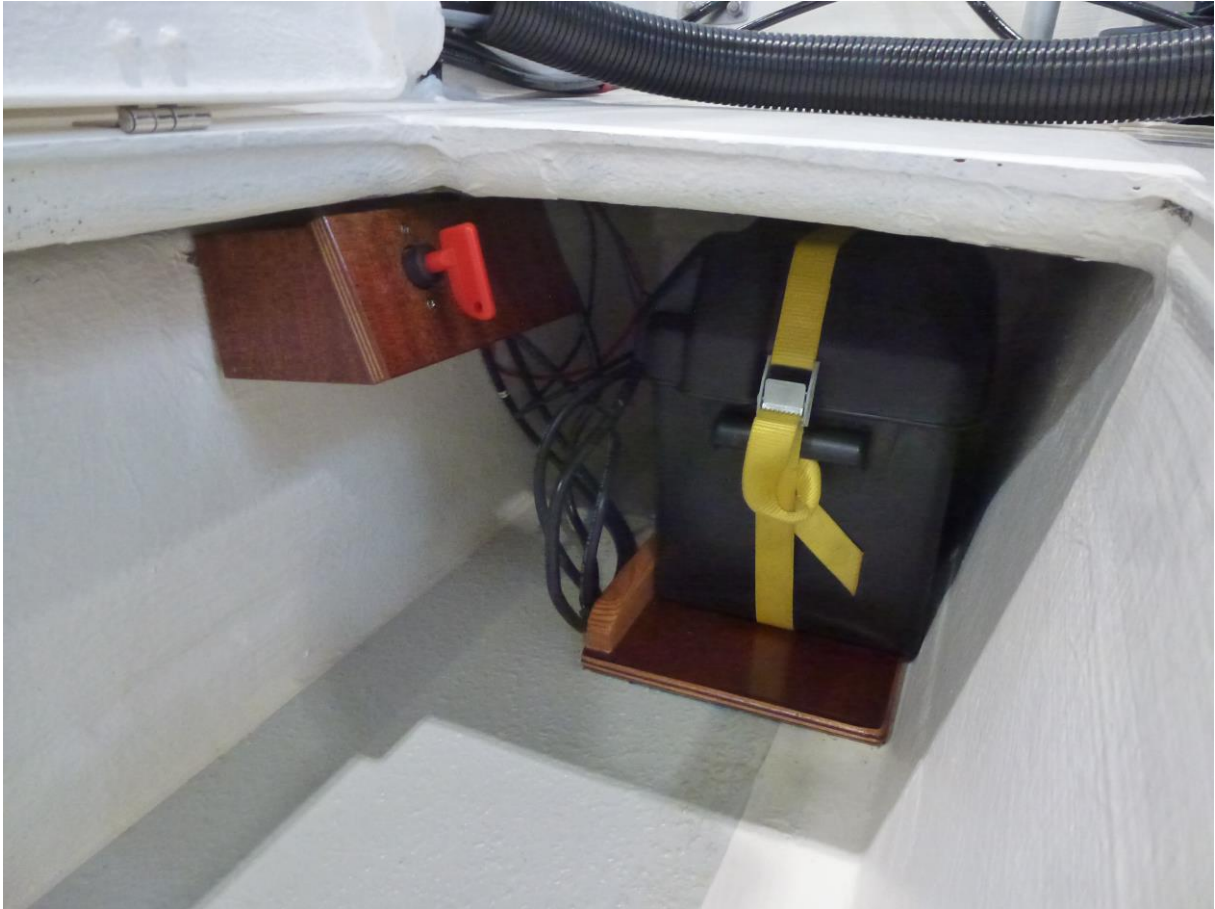
Batteriekasten und Hauptschalter im seitlichen Staukasten
